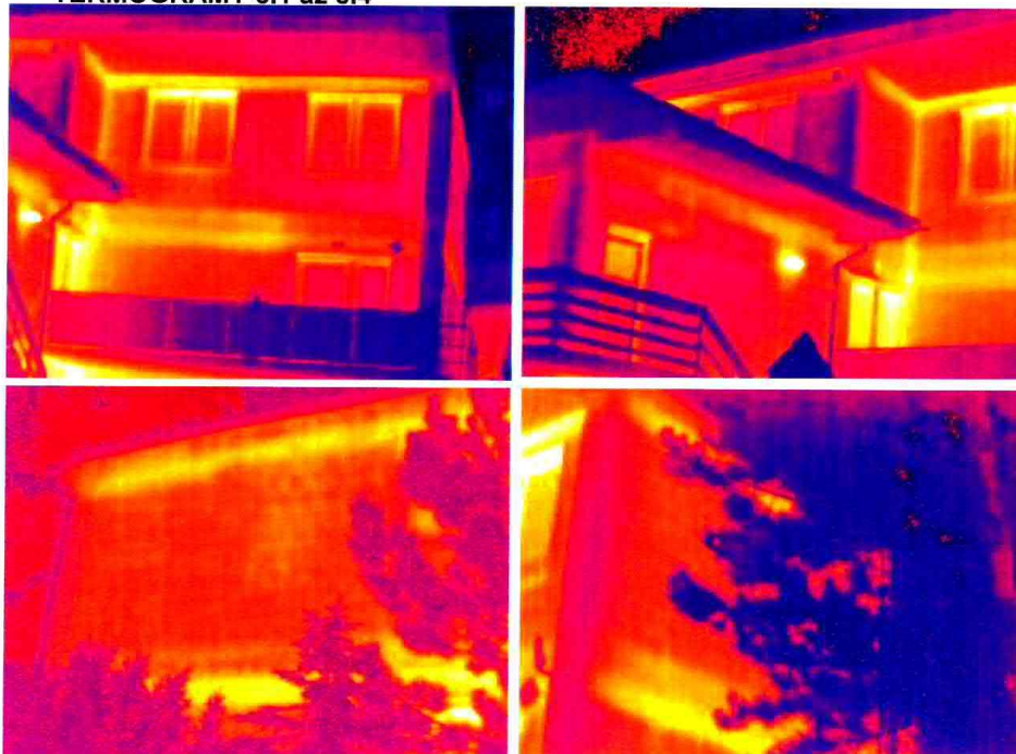
TERMOGRAMY č.1 až č.4
