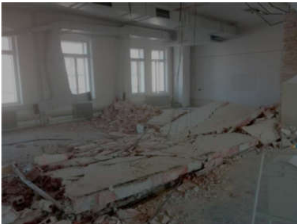
3.NP. Místnost do ulice. Ze zjištěného stavu příčky je prokazatelné, že příčka byla stržena. Tato dělicí příčka byla tl.15 cm. Stropní konstrukce byla v důsledku pádu zatížena dynamickým zatížením. To svědčí, že zhotovitel neprováděl řádně bourací práce.
