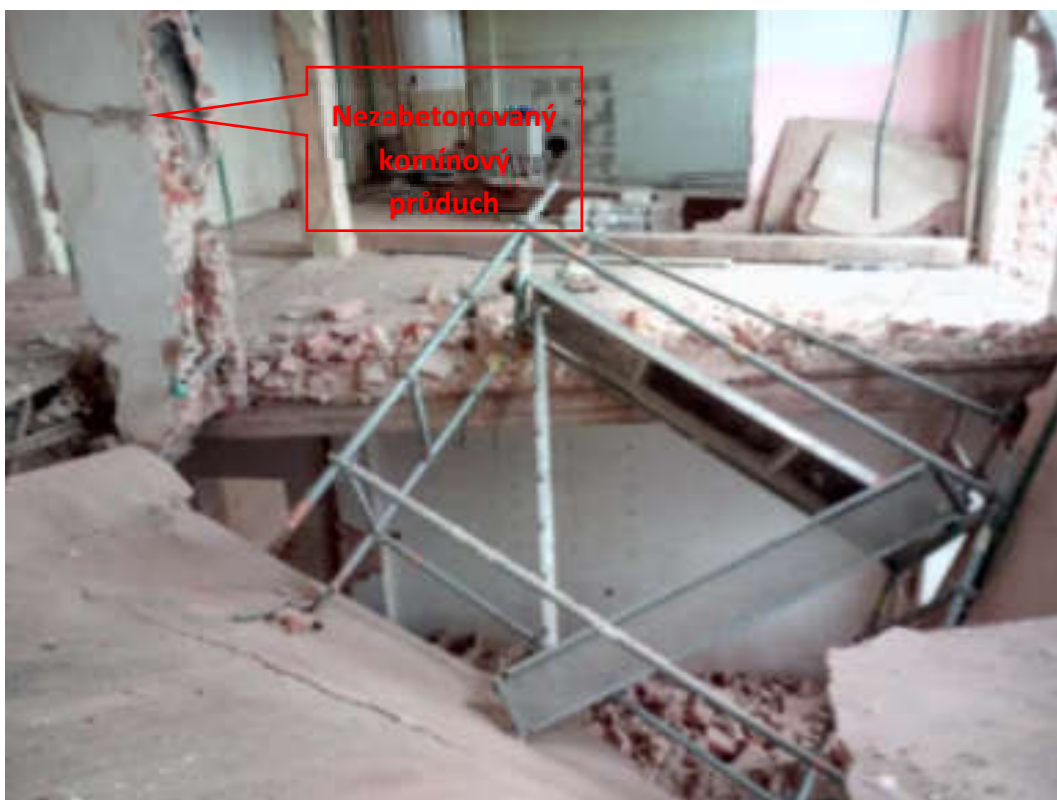
Stav v 2.NP, havárie stropu nad 1.NP.
