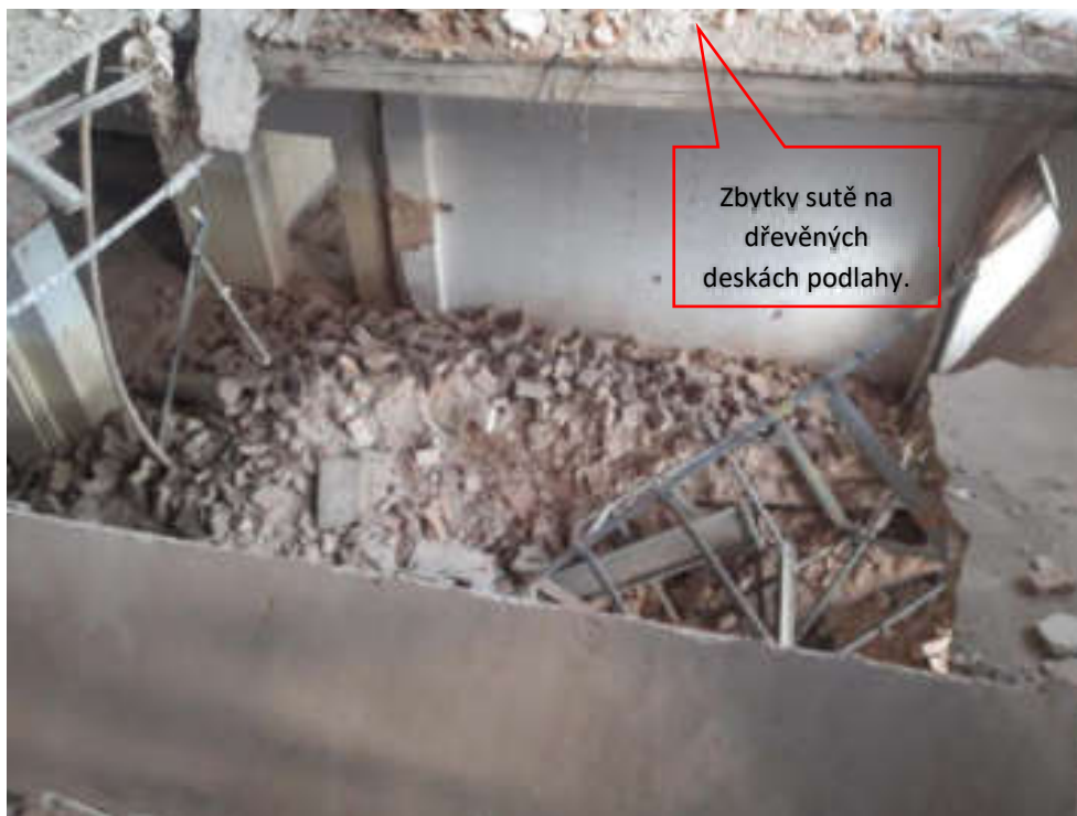
Zřícený dřevěný trémový strop nad 1.NP, zřícená příčná zeď a zřícená cihelná klenba stropu- u tohoto stropu zůstala konstrukce podlahy-dřevěné trámy a prkna podlahy, na kterých je patrná suť.
