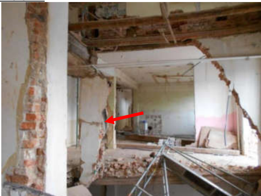
2.NP. Na obrázku vyznačen komínový průduch, který nebyl zabetonovaný před bouracími pracemi tak, jak požadoval projekt.
