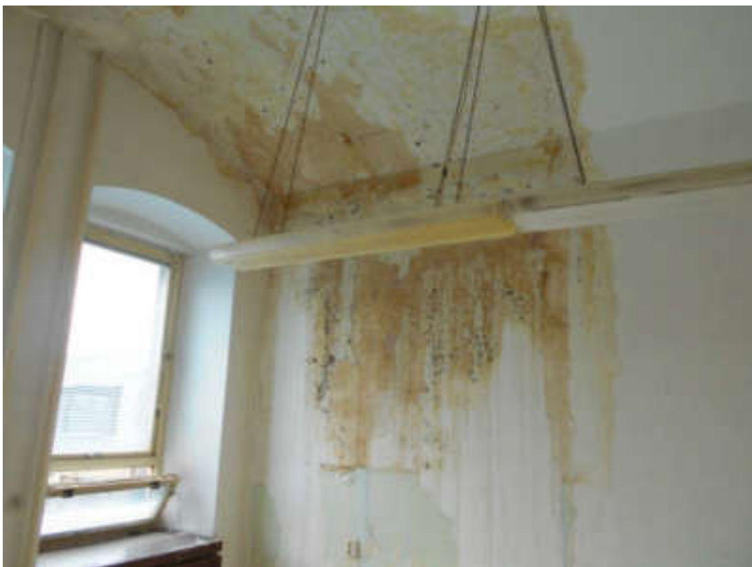
Zamokřená cihelná valená klenba stropu místnosti, zamokřená včetně povrchových úprav.
