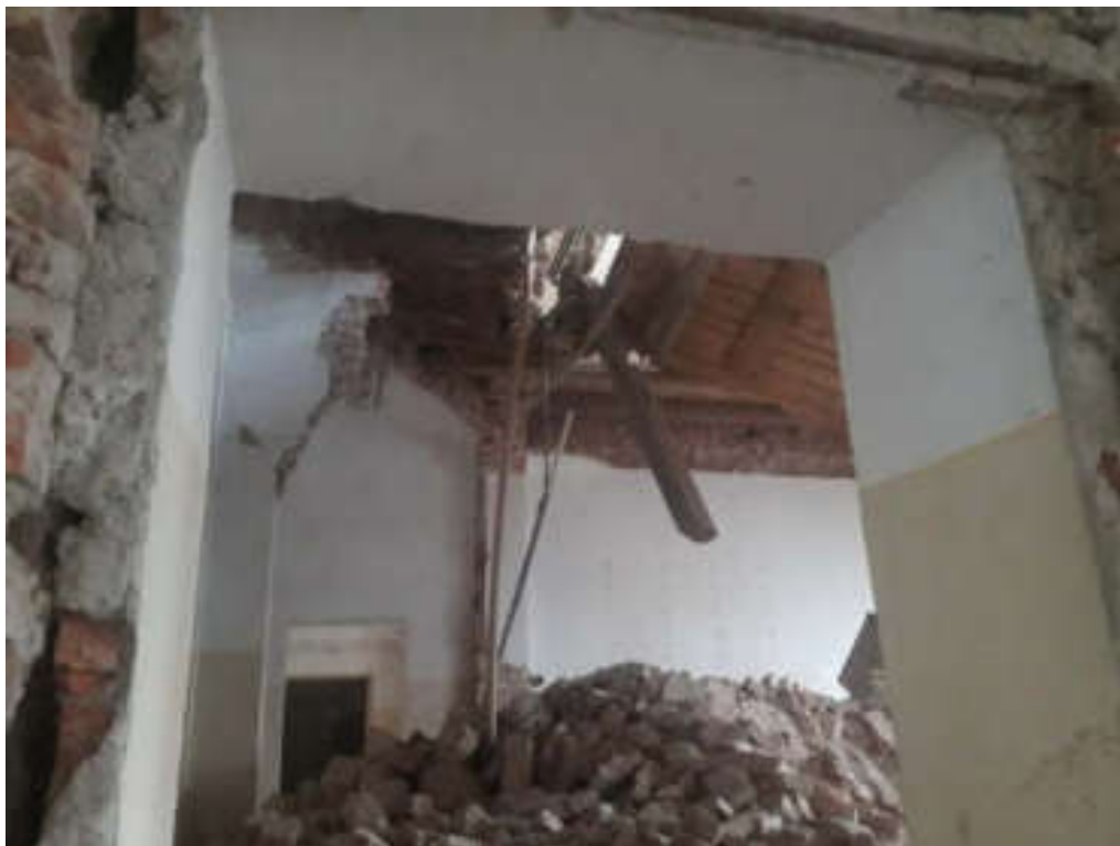
Zřícená příčná stěna s nikou a přilehlé stropní konstrukce chodby a místností.
