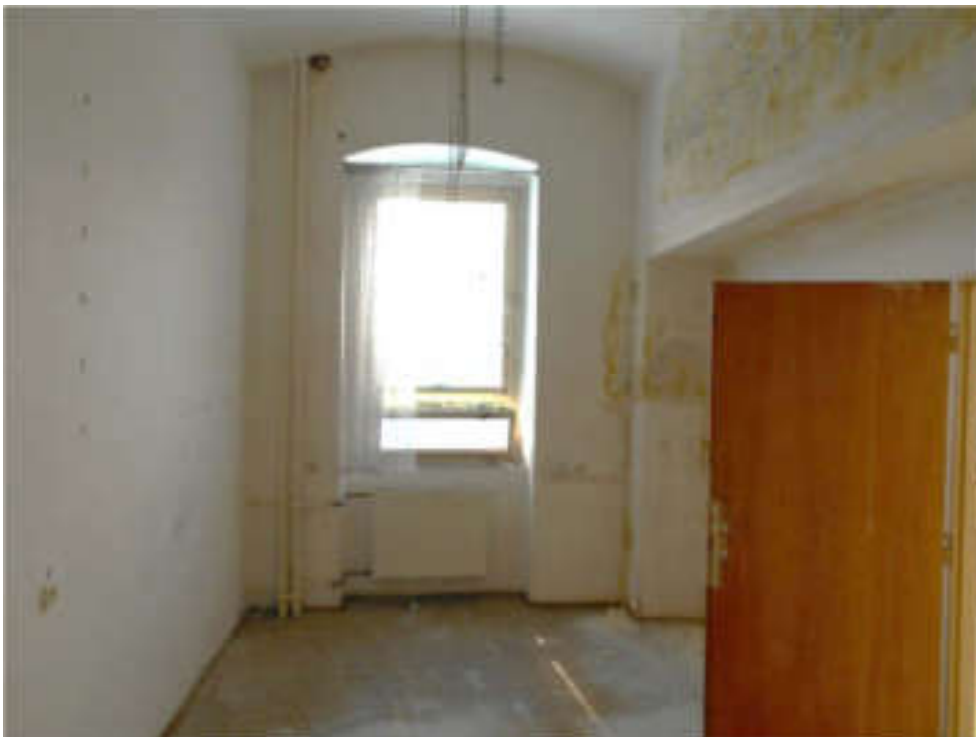
Zamokření zdiva a vnitřních omítek v důsledku havárie vodovodního potrubí. Na obrázku patrné provedení pilíře u obvodové zdi, kde došlo k havárii. Pilíř o výšce cca 2,4 m.
