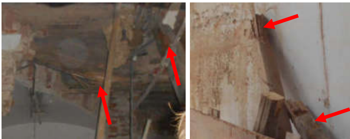
Poškození dřevěných prvků hnilobou v důsledku zatečení v minulosti a před předáním stavby.
