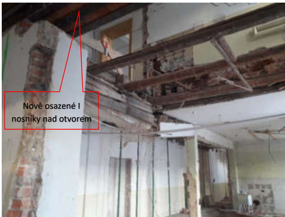
Pohled z 2.NP přes stropní konstrukci do 3.NP. Podélný průvlek vykazuje nadměrné deformace v důsledku havárie příčné nosné zdi (zdivo se celé zřítilo na strop nad 1.PP), na které byl uložen. Vyznačen nově provedený překlad nad otvorem z I nosníků. U stropní konstrukce zbyly pouze podhledové nosníky což svědčí, že iniciátorem havárie nehodl být pád stropu nad 2.NP.
