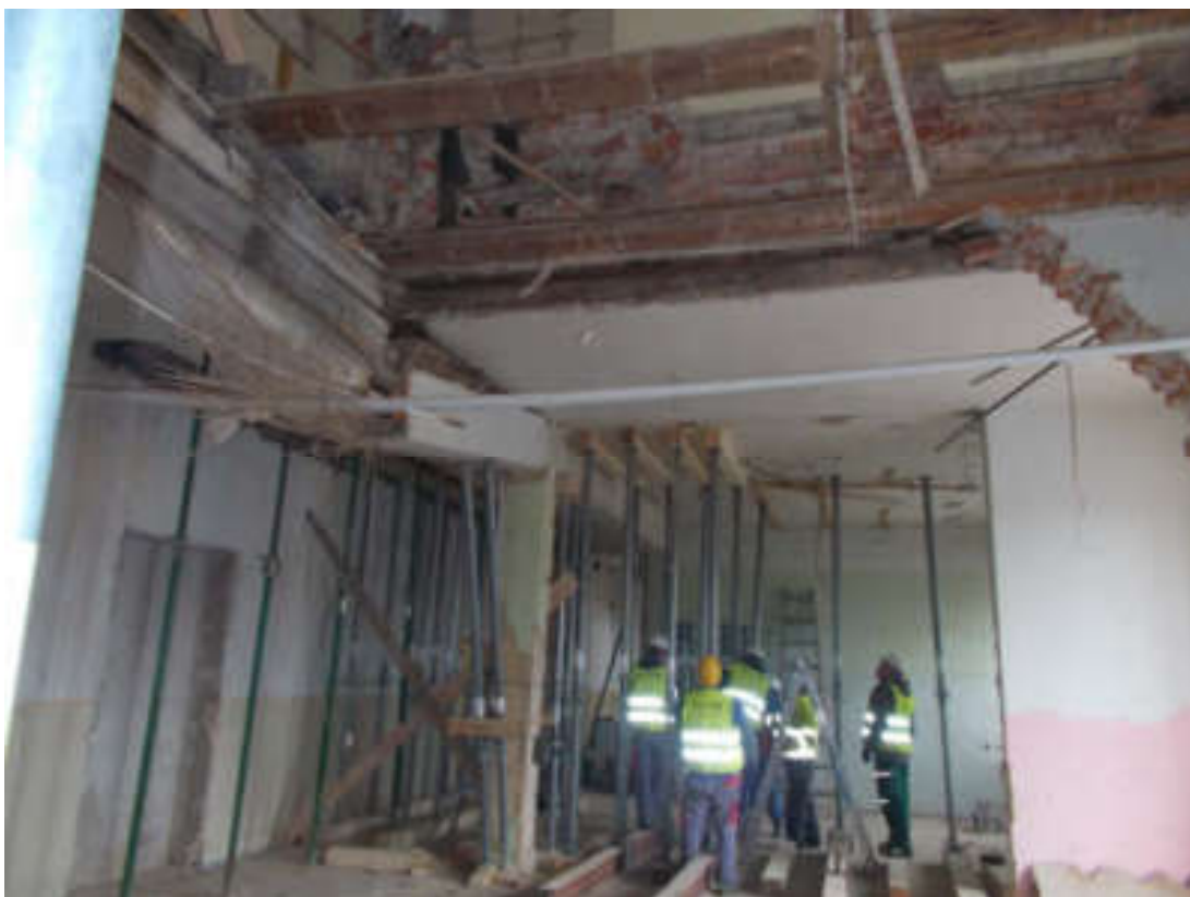
Podchycení stropu nad 2.NP z opačné strany místa havárie.
