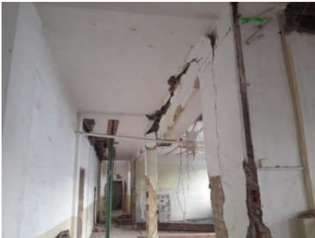
2.NP. Před bouracími pracemi zhotovitel nezabezpečil řádně podchycení okolních konstrukcí tak, jak požadoval projekt.
