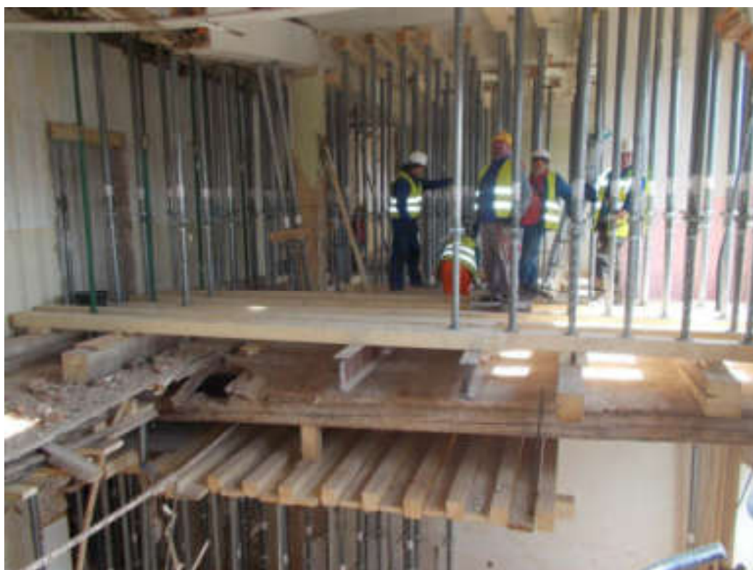
Podchycení v místě havarované nosné příčky.
