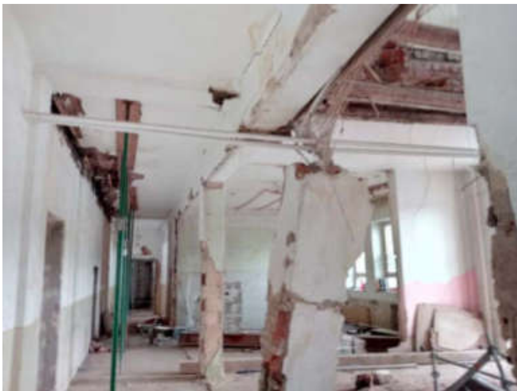
V době vzniku havárie nebylo provedeno řádné vystojkování stropních konstrukcí jak požadoval projekt. Stav ve 2.NP.
