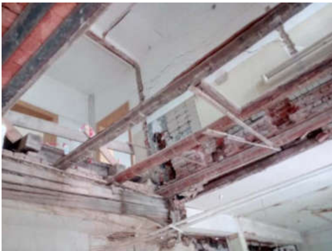
3.NP. Pohled na stavebně technický stav příčné vnitřní nosné zdi z plných pálených cihel poškozenou šikmými trhlinami. Na povrchu zdiva patrné umístění původního obkladu a potrubí umyvadla.
