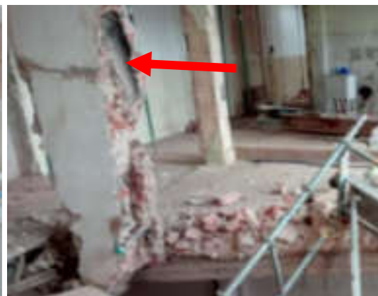
Nezabetonovaný komínový průduch.
