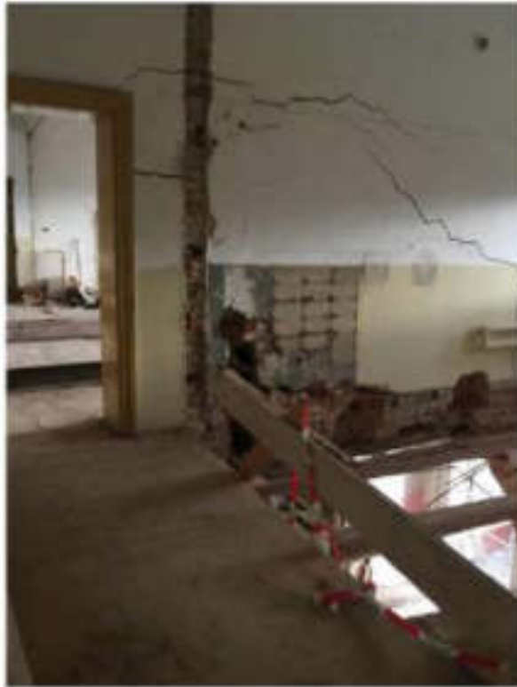
Stěna ve 3.n.p. „visí“ bez opory, navíc je oslabená kominovými průduchy
