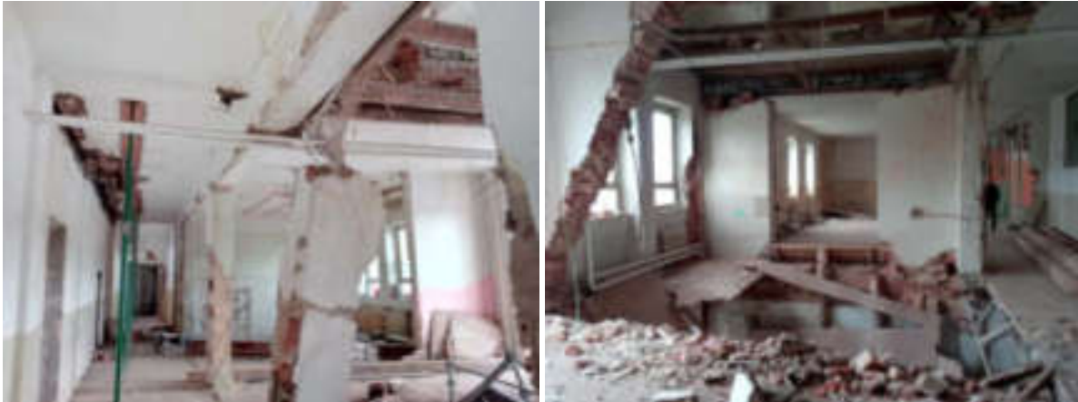
Neprovedené řádné zabezpečení okolních konstrukcí. Chybí podepření stojkami.
