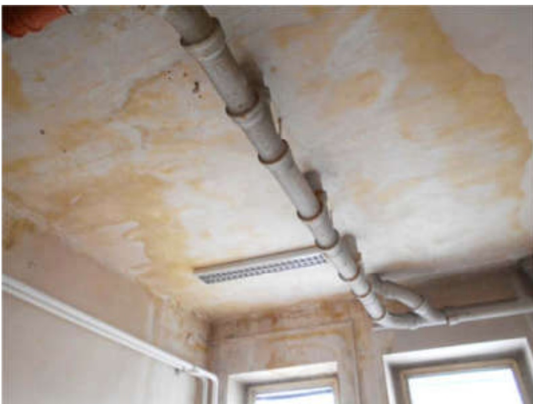
Zamokření dřevěného trámového stropu místnosti.
