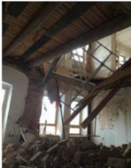
Pohled na havarovaný pilíř kolmý na fasádu – hladká styčná plocha bez vazby zdíva
