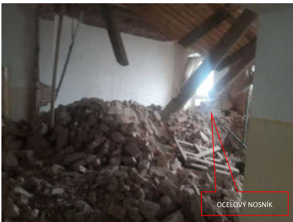
Zavalený ocelový nosník, který byl uložen nad nikou v nosné příčné stěně. Dle zavalení, lze usuzovat, že k prvotní havárii došlo na straně vnitřní podélné stěny.
