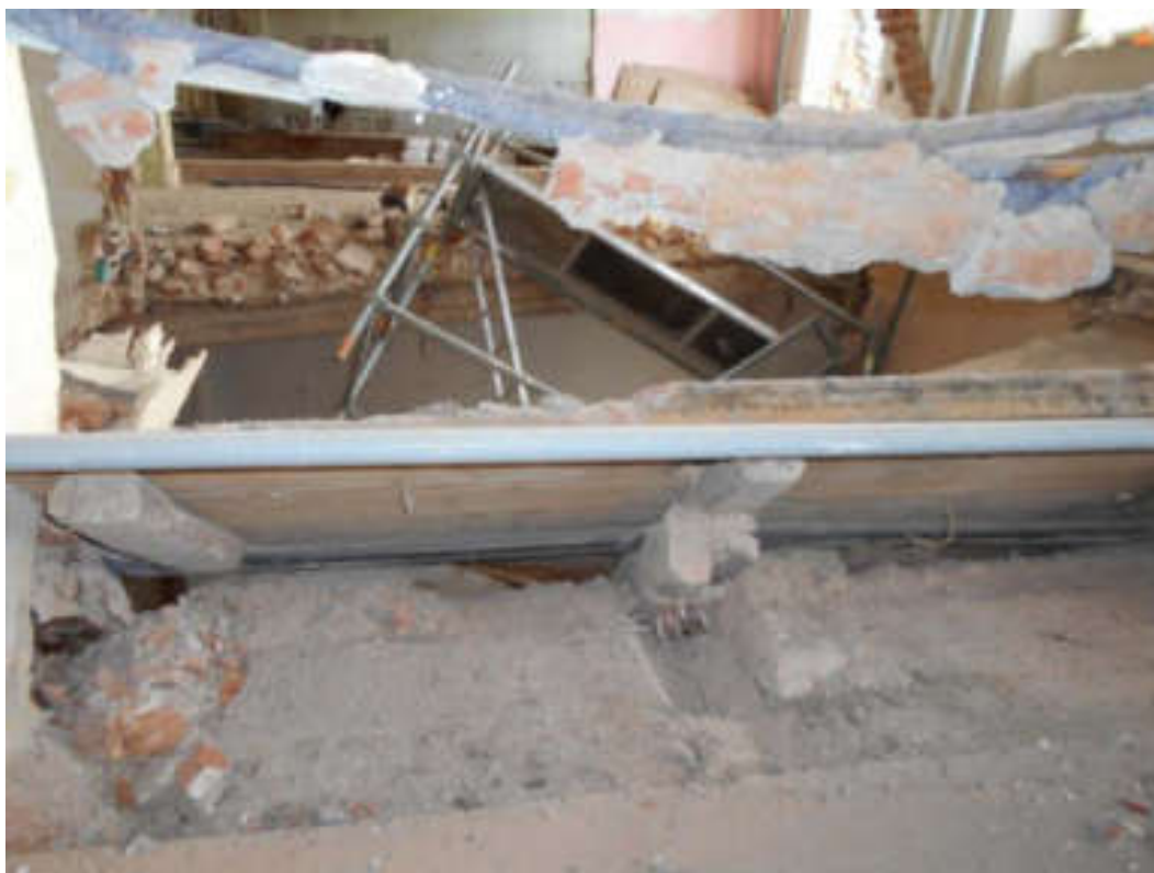
Pohled z 2.NP do 1.NP. Havárie stropu nad 1.NP.
