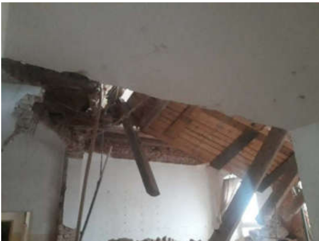
Zřícené stropní konstrukce nad 1.NP a příčné nosné zdivo vynášející klenbu stropu a dřevěné stropnice.
